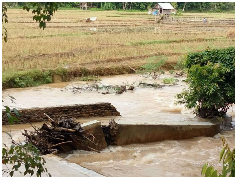
Gambar 2. 11 Irigasi yang rusak akibat banjir bandang di Aie Amo
